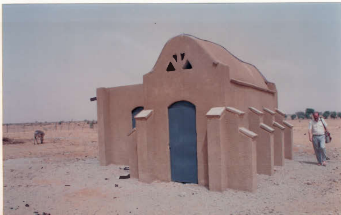
Photo 6: Voûte voilée. Aussi, le nombre important de contreforts sur la cuisine/magasin rend plus difficile un appareillage correct des murs.
