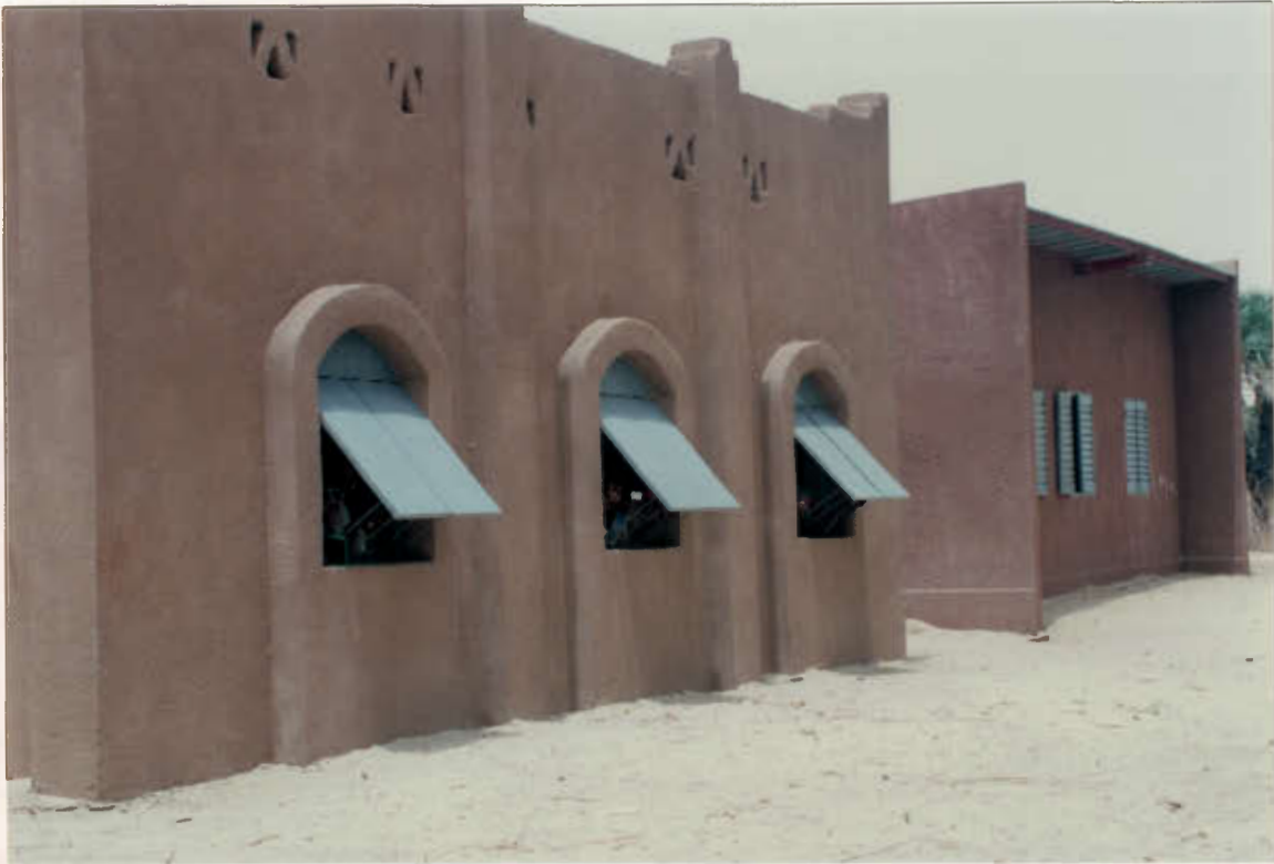
Photo 9: Volets exposés au rayonnement du soleil à partir de midi en saison chaude et pivotant en haut sans protection adéquate.
