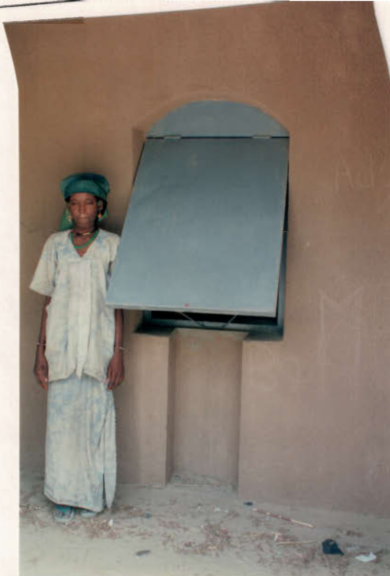
Photo 5: Volet pivotant en haut qui retombe avec force contre le cadre: plusieurs ont déjà dû être rescellés. A noter également le détail de maçonnerie sous la fenêtre qui rend plus compliqué l'appareillage des briques sans justification structurelle apparente.
