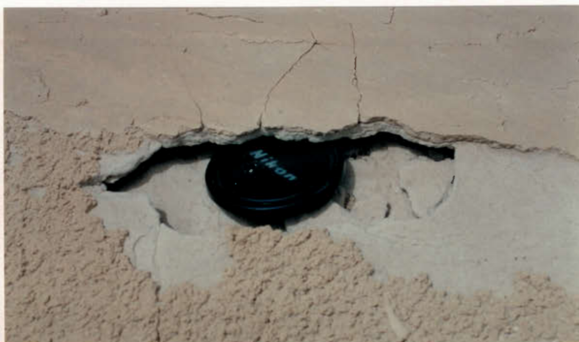
Photo 8: L'enduit sur les voûtes est souvent fissuré et décollé.
