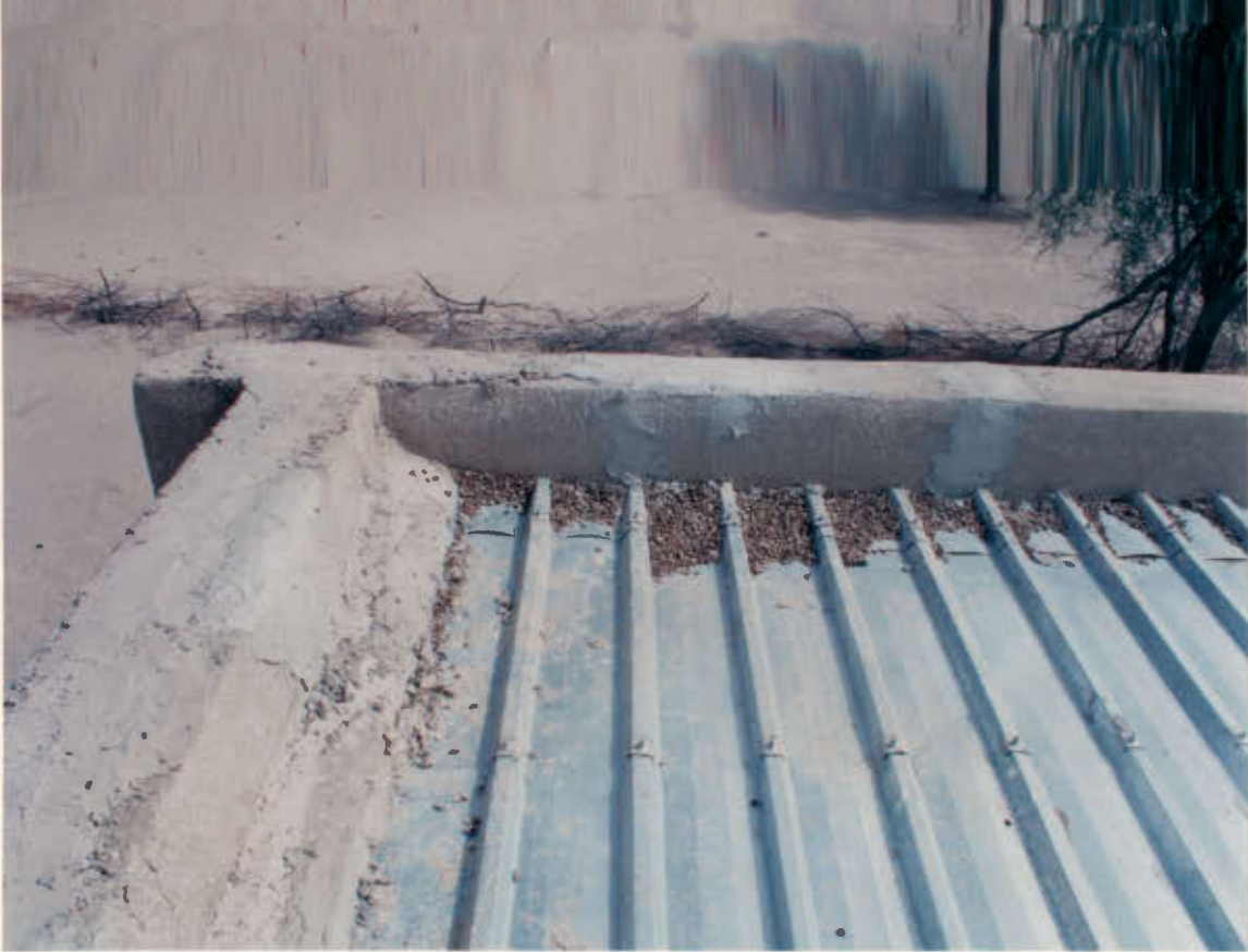
Photo 3: Détail du joint entre l'acrotère et la tôle. Ici, l'entrepreneur a tenté de résoudre le problème d'infiltration d'eau par le joint entre la tôle et l'acrotère en ajoutant un couvre joint en ciment, qui risque toutefois de se fissurer et de laisser pénétrer l'eau de nouveau, (Yebi).
