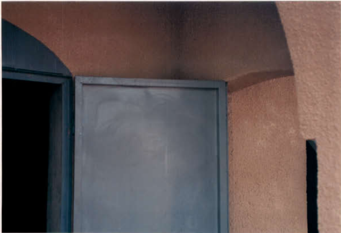
Photo 4: Ouvrants de portes fabriqués et posés à l'envers qui viennent heurter contre l'arche adjacente.
